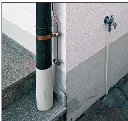
Bild 9: Verbindung von Regenrinne und externem Wasserhahn mit dem Tiefenerder
