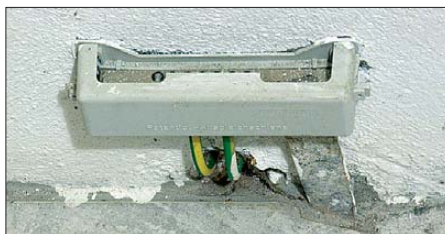
Bild 3: Potentialausgleichsschiene am Fundamenterder in Kellerraum
