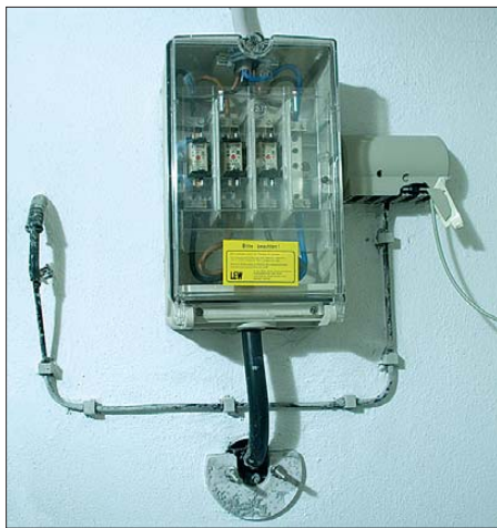
Bild 1: Typische Hauskabeleinführung für Strom und Telefon
