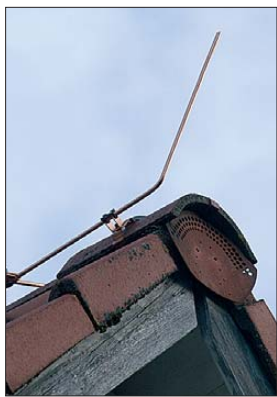
Bild 6: Fangspitze (50 cm) am Dachfirst
