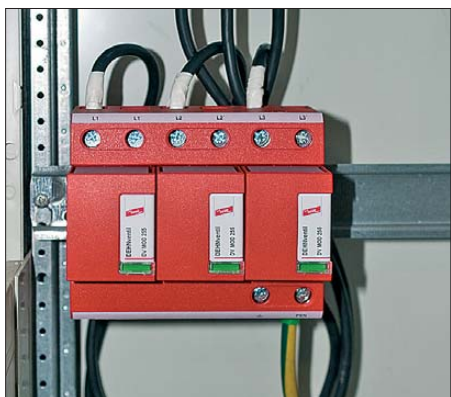
Bild 7: Dehn-Überspannungsableiter für Stromzuführung, dreiphasig, in Sicherungskasten auf Hutschiene montiert
