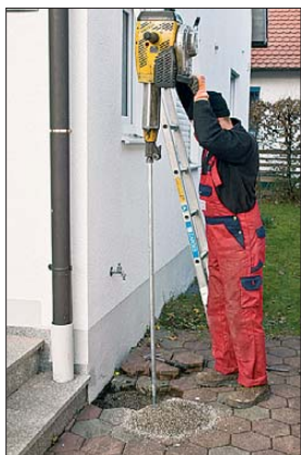
Bild 2: Um die Tiefenerder (25-mm-Stangen, je 1,50 m lang) in den Boden zu treiben, ist schweres Arbeitsgerät erforderlich.
